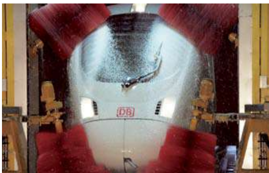
Zugwaschanlage der Geschäftsbereiche Automation und Anlagenbau (Frey)
